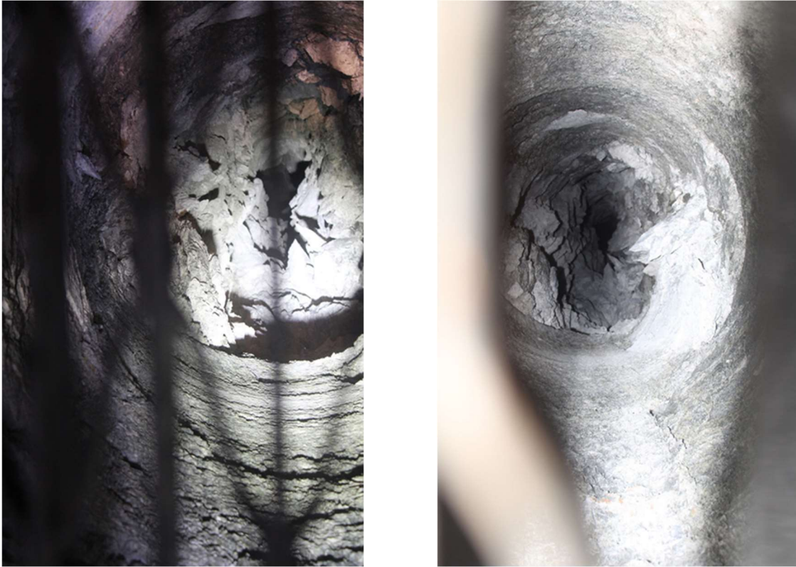
Figur 3 Kraftig uppsprickning och konvergens efter färdig raiseborring.
